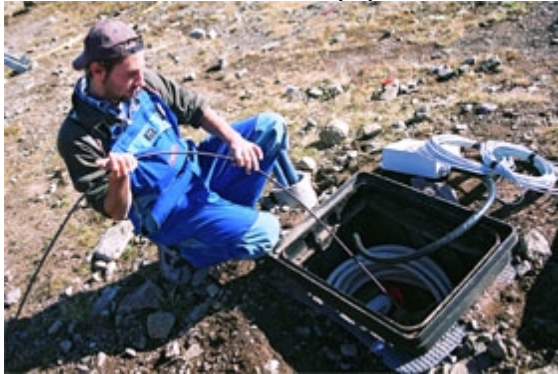
Die Hubs wurden schon im Sommer für die WM installiert.
