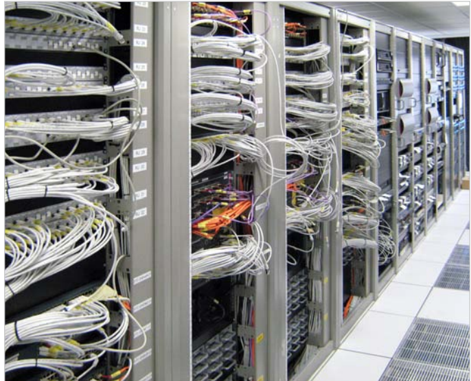
France 24 nutzt ein zentrales Netzwerk für Kommunikation, AV-Strukturen und Internet.
